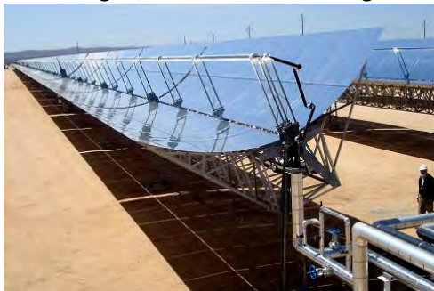
FOTO: PA/DPA Ein Solarkraftwerk, gebaut von Solar Millenium.
